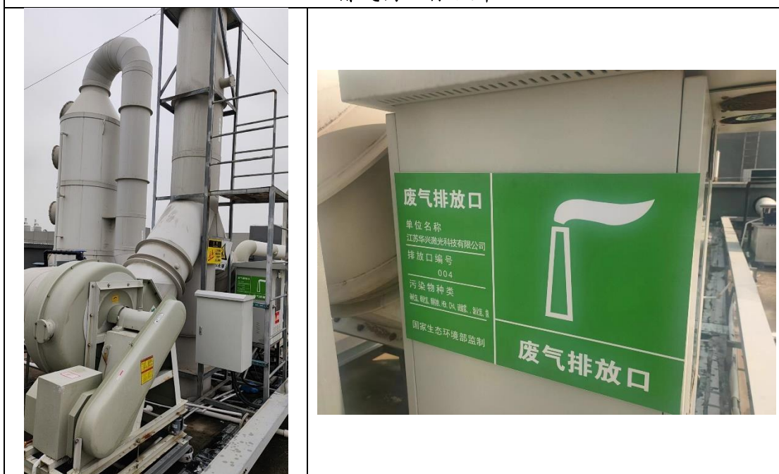
004 排气筒及标识牌
