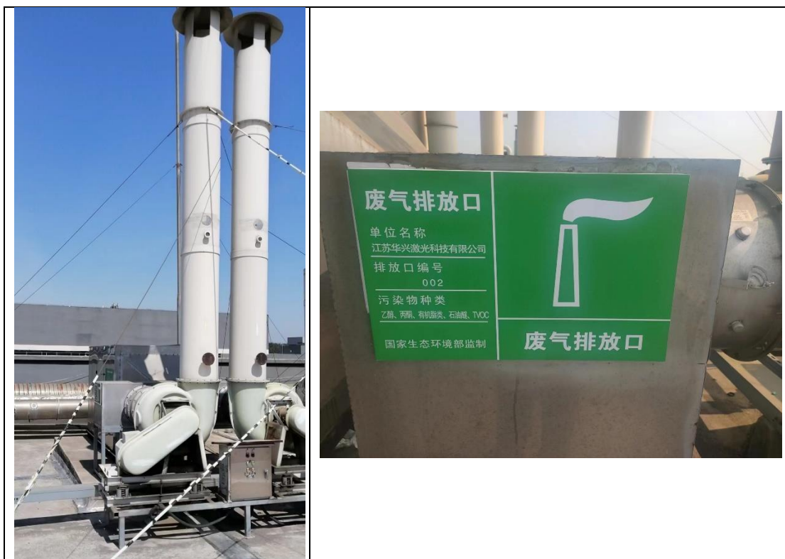
002 排气筒及标识牌
