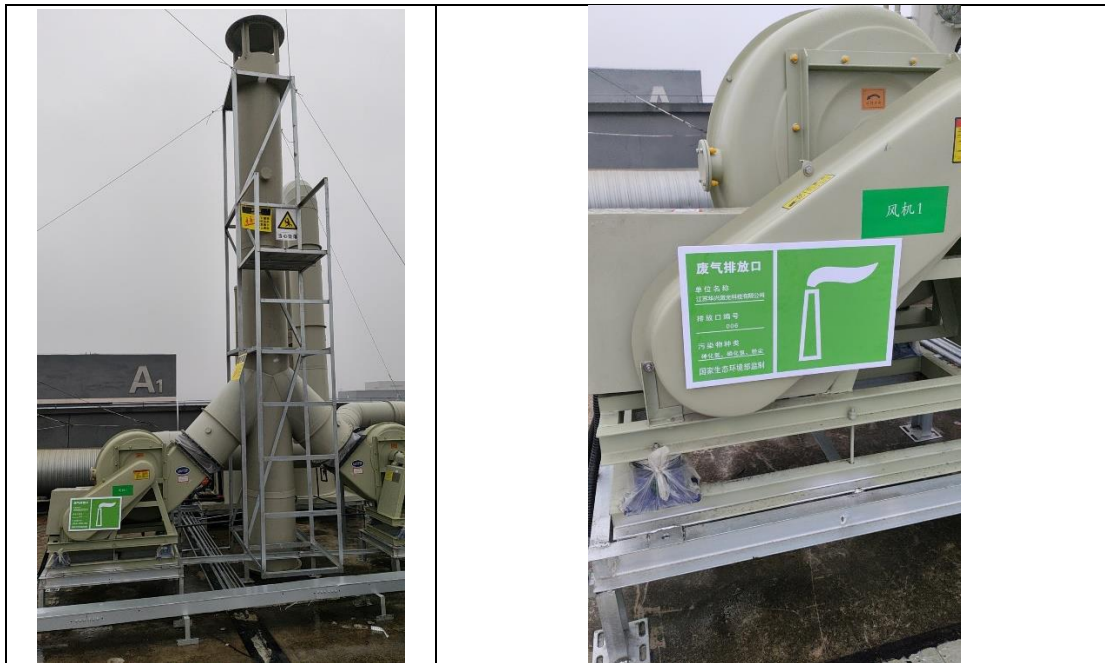
006 排气筒及标识牌
